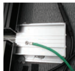
05 Mise à la terre du système
